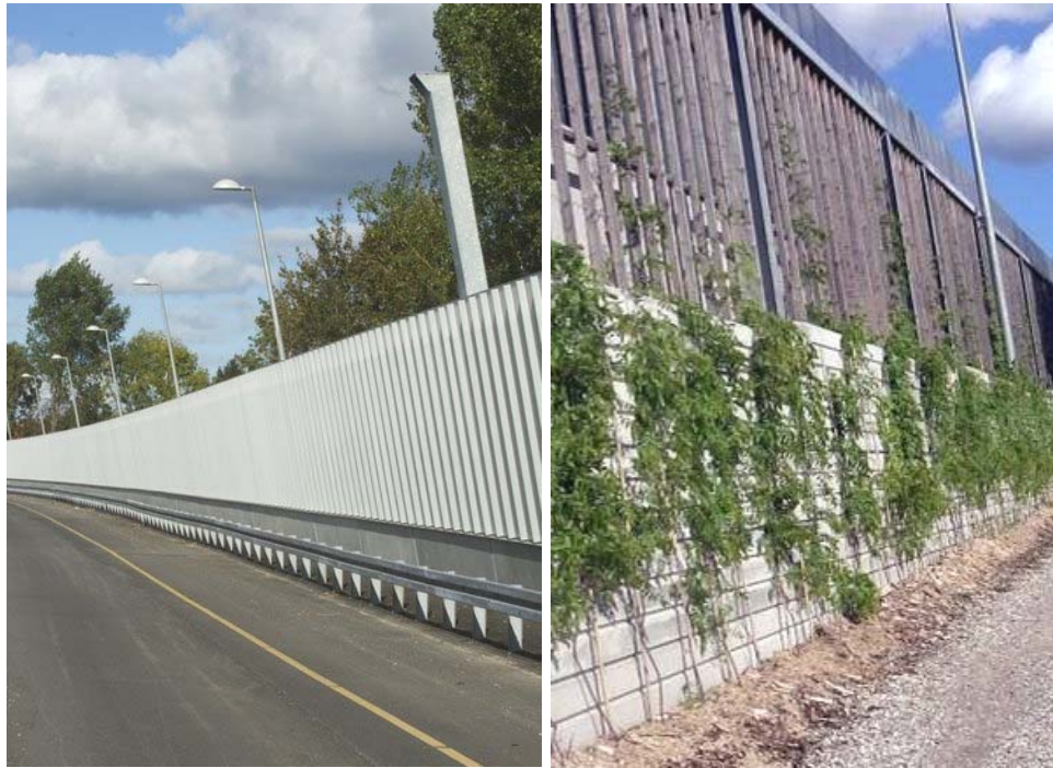
Figur 5.4. Støjskærme designet specielt til M3 projektet (til venstre set fra vejsiden og til højre fra boligområderne).
