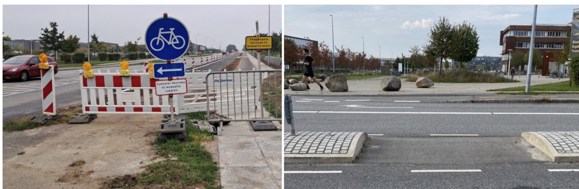
Figur 3. Til venstre ses skiltning ved overledning, hvor cyklister henvises til cykelsti i modsatte vejside. Til højre ses helleanlæg i kombination med kantstensopspring og manglende rampe på modsatte vejside - delvist ud for helleanlægget. (Fotos: Trafitec 2024).
