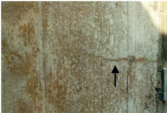
Enkelt revne (Siø Sundbroen)
