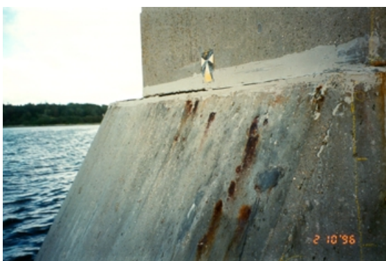
"Rustpletter" - udfældning af røde korrosionsprodukter (Sallingsundbroen)
