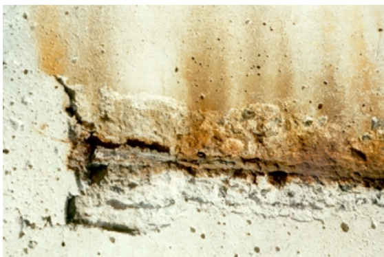
Korroderet armering, afskallet dæklag (Vejlefjordbroen)
