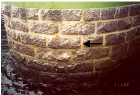
Enkelt grov revne (sten-mørtel) i paret uden udfældninger (Vilsundbroen, pille 4)
