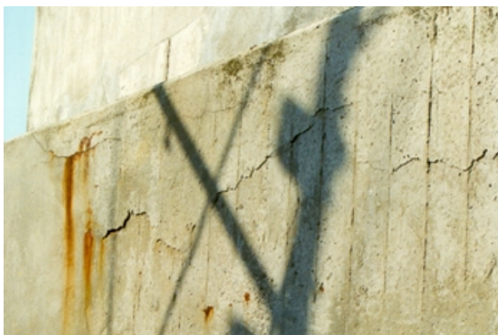
Delamineret/Løs beton (Langelandsbroen)
