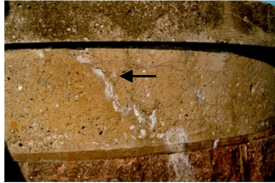
Netrevner og revne med hvide udfældninger (Siø Sundbroen)
