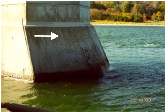
Alge/mos over splashzonen (Sallingsundbroen)
