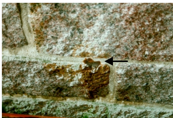
Udfældning af korrosionsprodukter i fuger i parament (Langelandsbroen)
