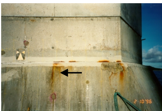
Revne med udfældning af korrosionsprodukter (Sallingsundbroen)
