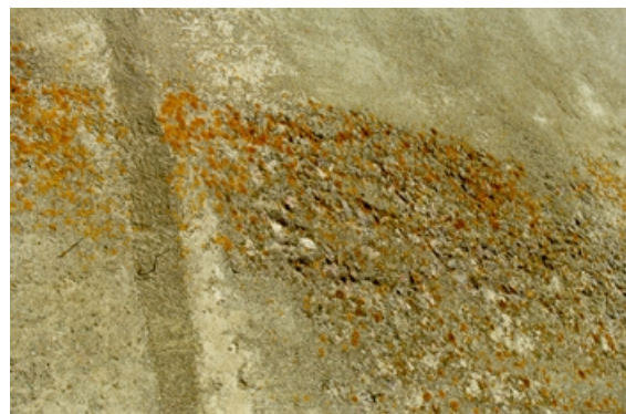
Mos / forvitring (Langelandsbroen)
