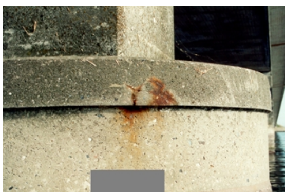
Revne med udfældning af korrosionsprodukter (Siøsundbroen)
