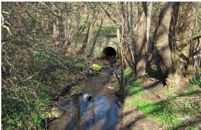
FIGUR 7.5 Underføring af Skejrups Bæk under Rute 15
