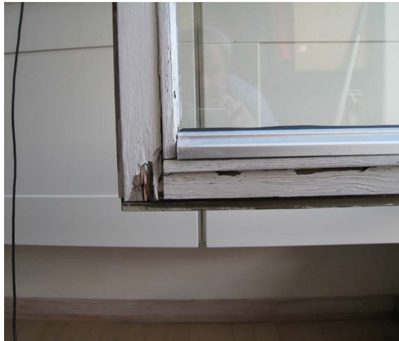
FIGUR 33 De eksisterende vinduer var i dårlig stand.
