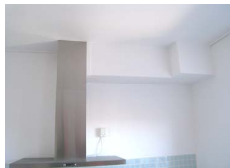
FIGUR 31 Eksempel på emhætte med lydsluse. Kanalen med lydsluse er skjult af en gipsinddækning.
