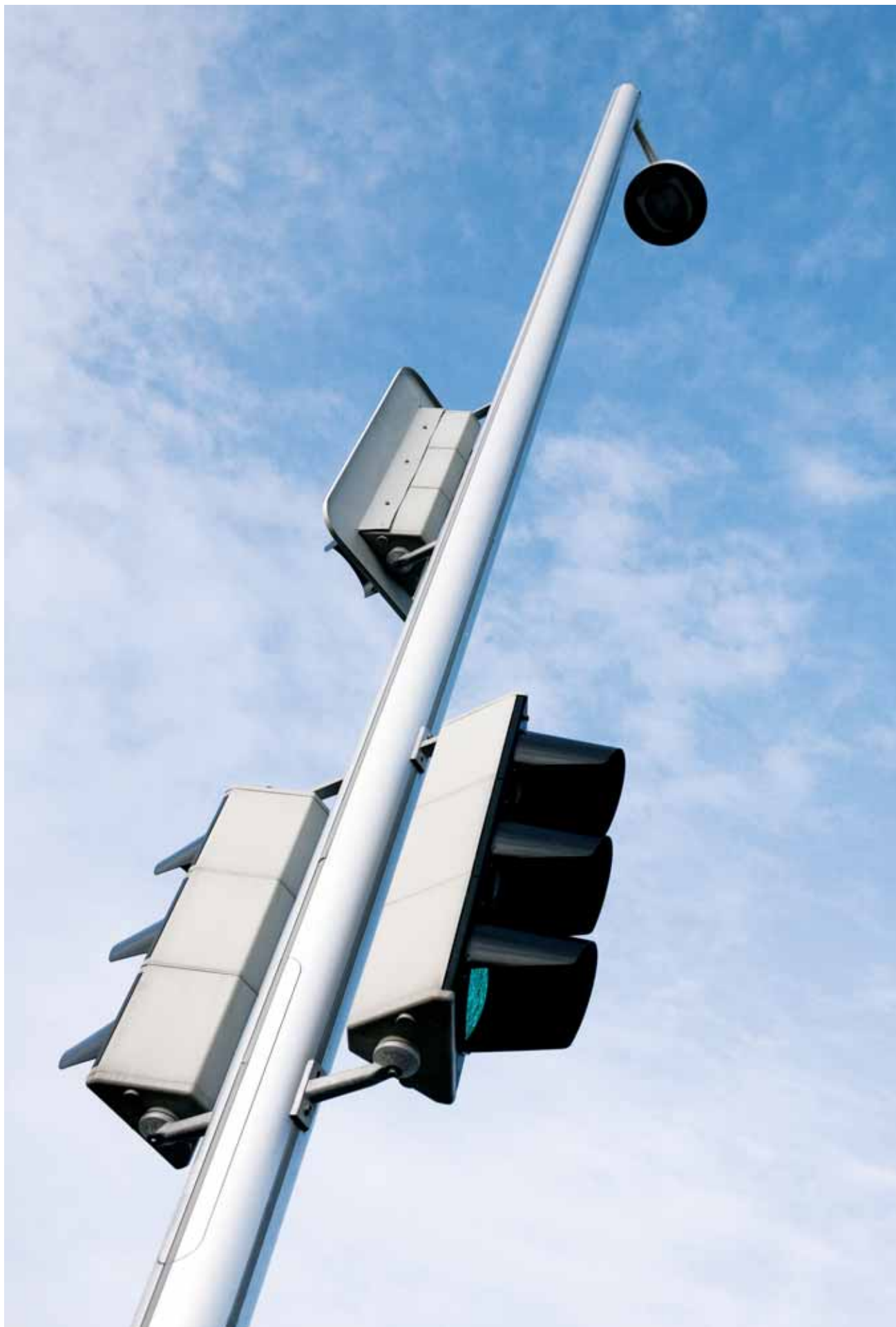
Billede 8-3 Milewide kombimast med belysningsarmatur og signalanlæg.
