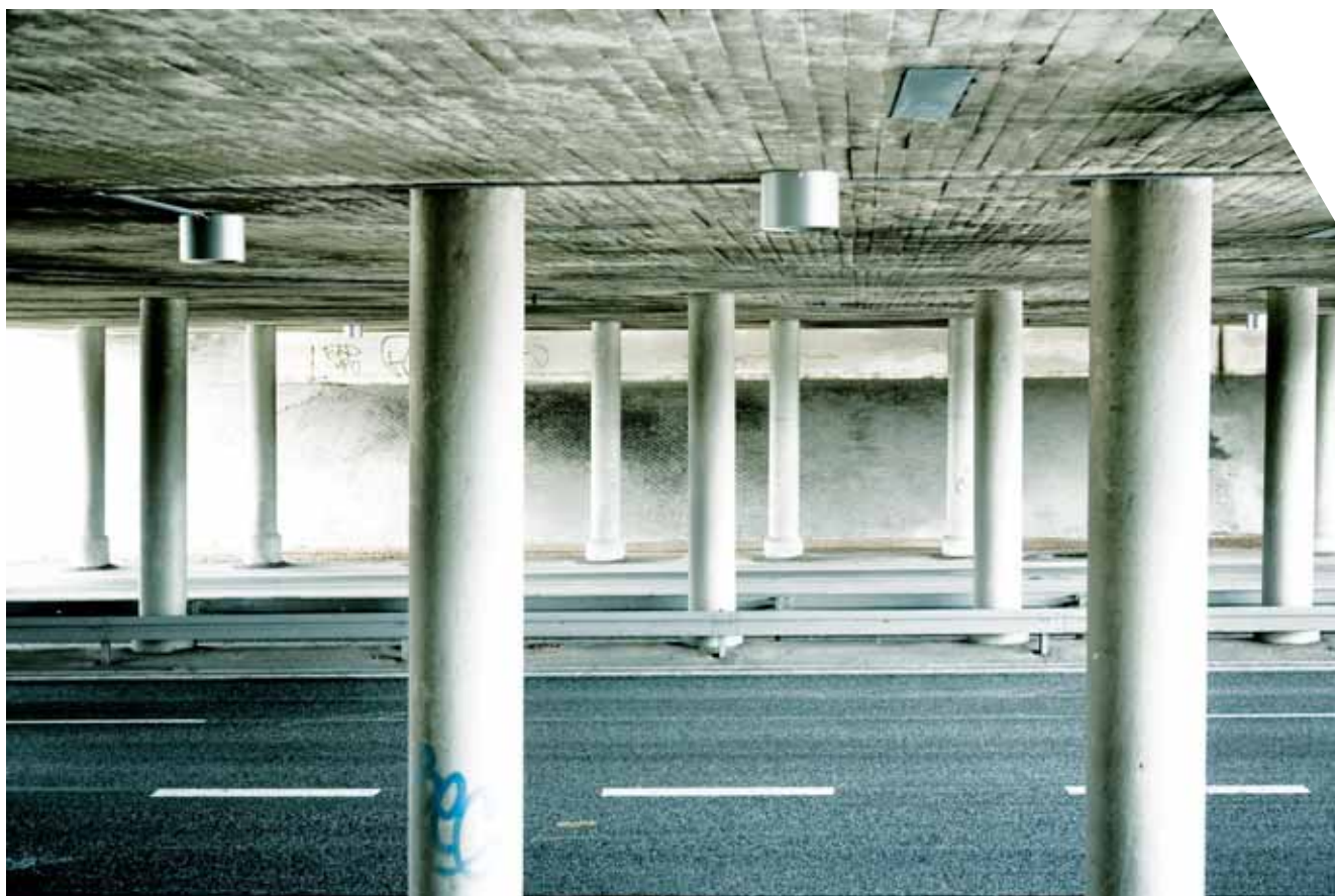
Billede 6-11 Underføring type 2 med egen belysning. Armaturer er monteret i loftet (Gladsaxe Ringvejs underføring under Motorring 3).
